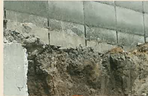
隣地、境界線では十分な基礎が取れない
