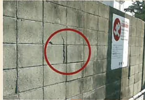
ブロック塀の劣化
